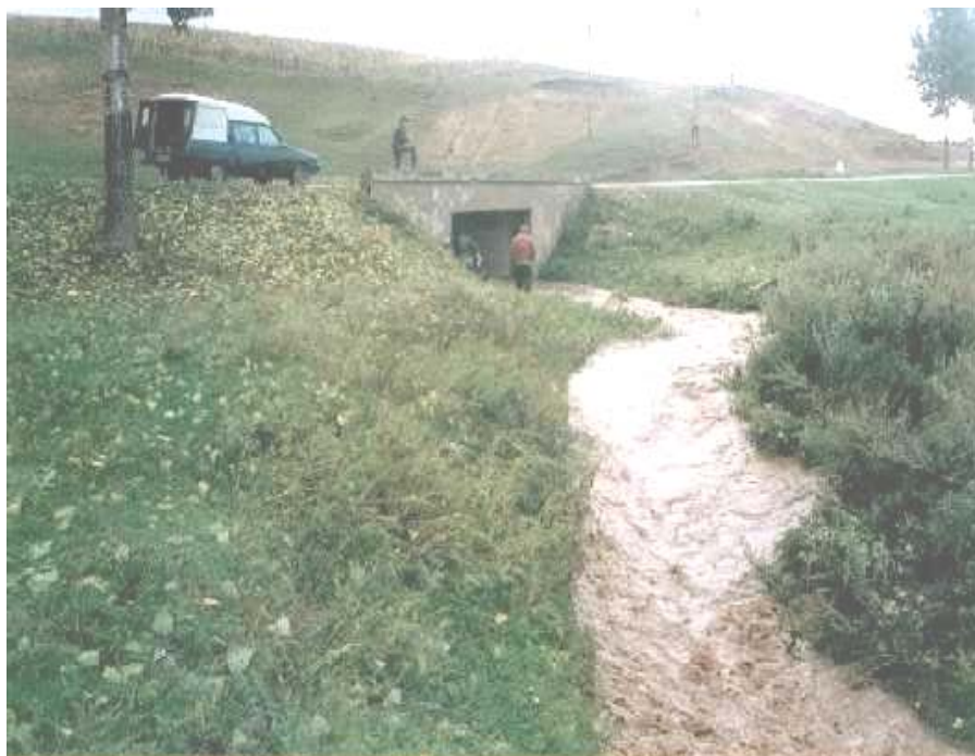
foto 2.8 Scurgeri provocate de evenimentele pluviale din septembrie 1996
